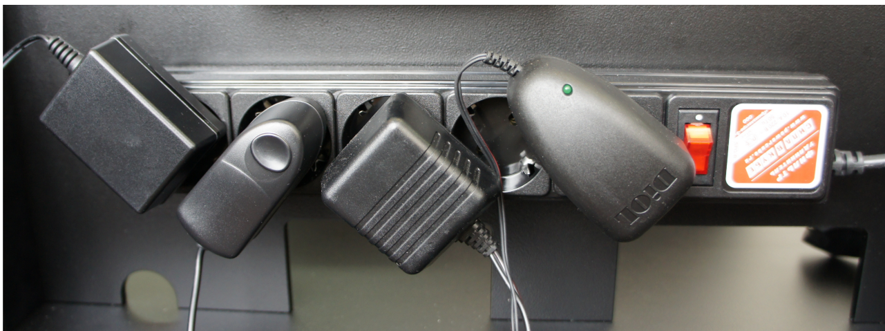
Рисунок 8 – Подключение блоков питания к сетевому фильтру. Слева направо: блоки питания весов, анализатора, насоса и мешалки
